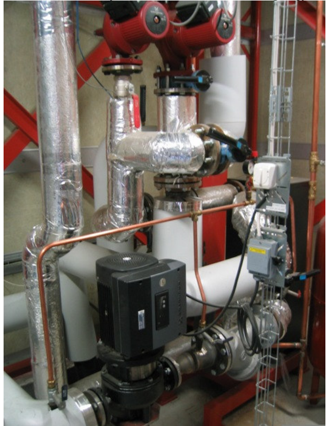
Manöverrummets rörinstallationer med nyckeln i handen
