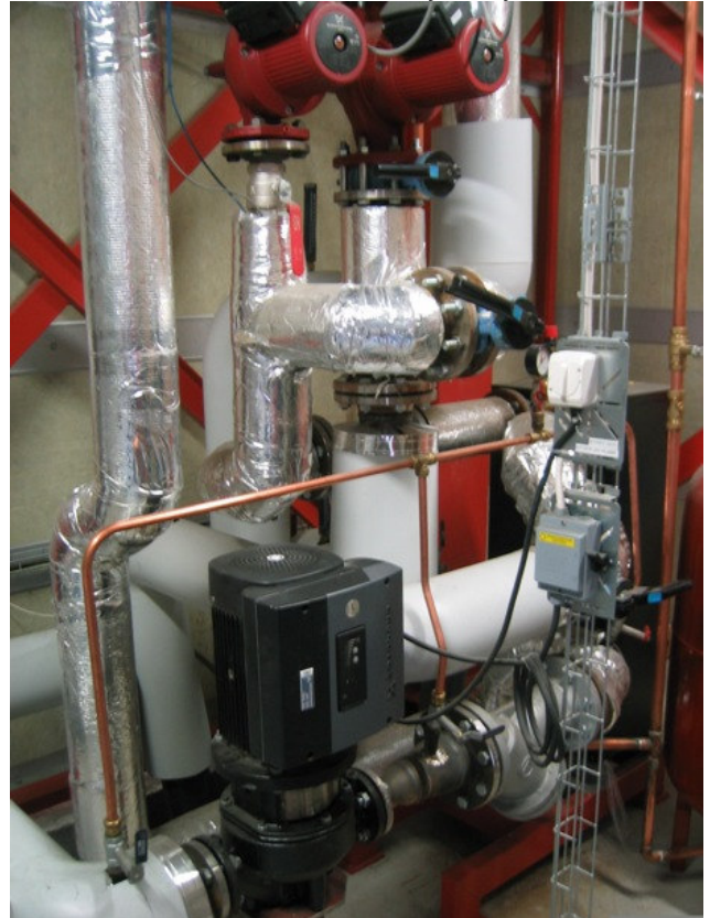
Ohjaushuoneen asennuksia avaimet käteen
