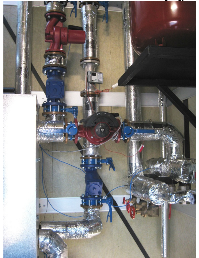
Manöverrummets rörinstallationer med nyckeln i handen
